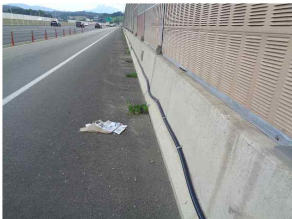
배수시설 S1 배수구 토사퇴적
