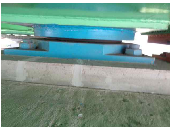
교량받침 P2-Sh1 받침물탈 균열( C_w=0.3\text{mm} 미만)
