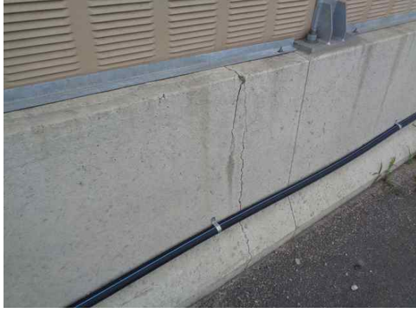
방호벽 S1 접속부 파손(0.1×1.5)
