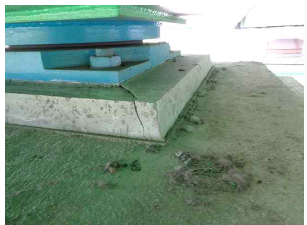
교량받침 P2-Sh1 받침물탈 파손( 0.2 \times 1.0 )
