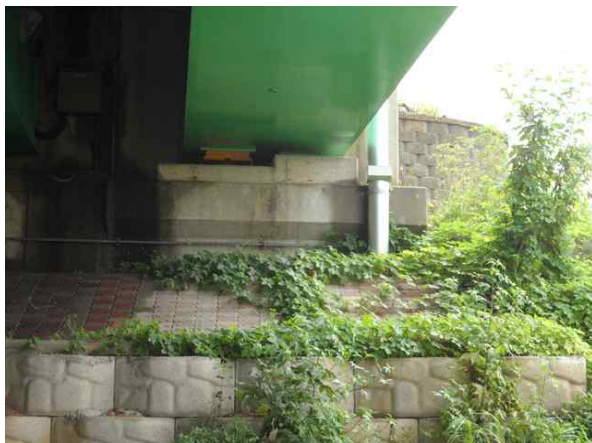
교대 A2 상태양호
